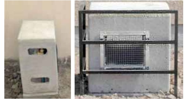
ALGUNOS EJEMPLOS ACEPTADOS EN LA INSPECCIÓN
